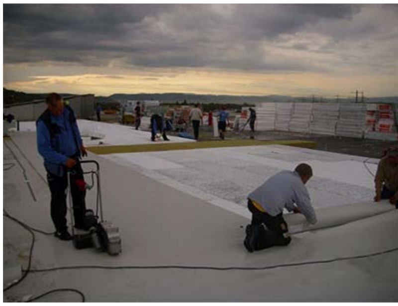
4 Der geringe Materialeinsatz in der einlagigen Verlegung spart Ressourcen und verringert die Brandlast
