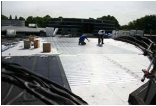
Bild: flachdachintegrierte Solarthermie
